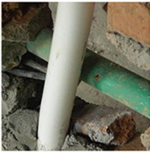
รูรั่วเพราะเจาะตะปูถูกท่อในผนัง
